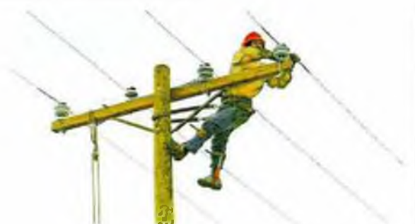
Hình 79: Nguy cơ tai nạn điện giật
